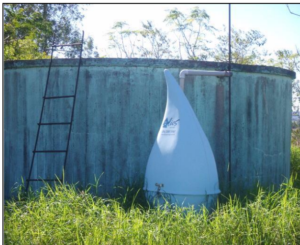
FOTO 03 – Dosador de flúor/Tratamento
