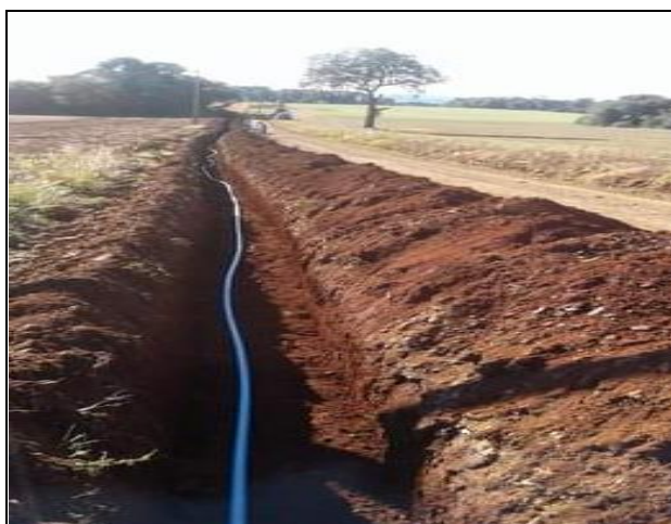
FOTO 05 – Rede de Distribuição
