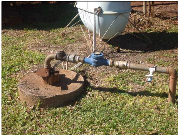
FOTO 01 – Captação da Água
