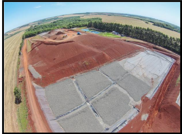
FOTO 02 – Estações de Tratamento
